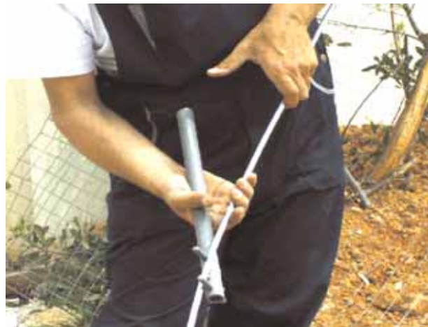
Βήμα 15. Αναμονές (δηλ. αγωγοί γείωσης 1) ) από τη θεμελιακή γείωση προς το εσωτερικό του κτηρίου για ισοδυναμικές συνδέσεις. Μπορούμε να τις εκτελούμε με γαλβανισμένο αγωγό Ø8mm ή Ø10mm, που τον οποίο τον ισιώνουμε πριν τον τοποθετήσουμε με ισιωτήρα, κωδικού ΕΛΕΜΚΟ 6900100.
