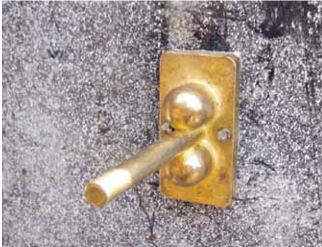
Βήμα 20. Πριν τη σύνδεση του “αγωγού γείωσης” με τον ακροδέκτη, τον καρφώνουμε με δύο καρφιά που τα περνάμε από τις τρύπες που έχει ο ακροδέκτης σε εσωτερική επιφάνεια ξυλότυπου κολόνας ή τοιχίου. Για το λόγο αυτό η στήριξη του πρέπει να γίνει πριν κλείσει ο ξυλότυπος.
