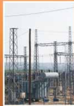
Υποσταθμοί ΜΤ/ΥΤ Substations ΜΤ/ΥΤ
