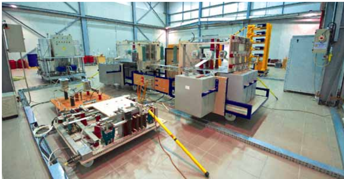
Εικόνα 12: Γεννήτρια παραγωγής κεραυνικών ρευμάτων 100kA, 10/350μs για πραγματοποίηση δοκιμών σύμφωνα με τα εθνικά και ευρωπαϊκά πρότυπα ΕΛΟΤ EN σειράς 50164 του εργαστηρίου της ΕΛΕΜΚΟ ΑΒΕΕ
